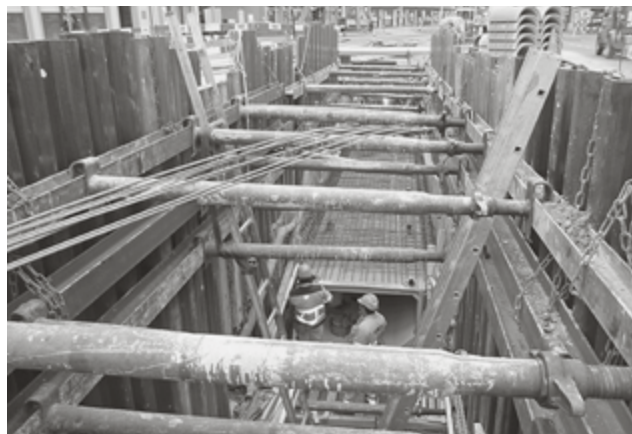
Dank intensiver Bauweise und Vorfabrikation konnte die Riedtlistrasse in lediglich zehn Monaten saniert werden. (Bild TAZ)
